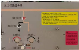
三工位隔离开关操作面板
